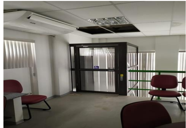
Figura 23. Plataforma elevatória na Biblioteca
