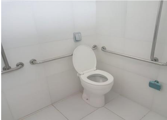
Figura 24. Sanitário acessível com barras de apoio
