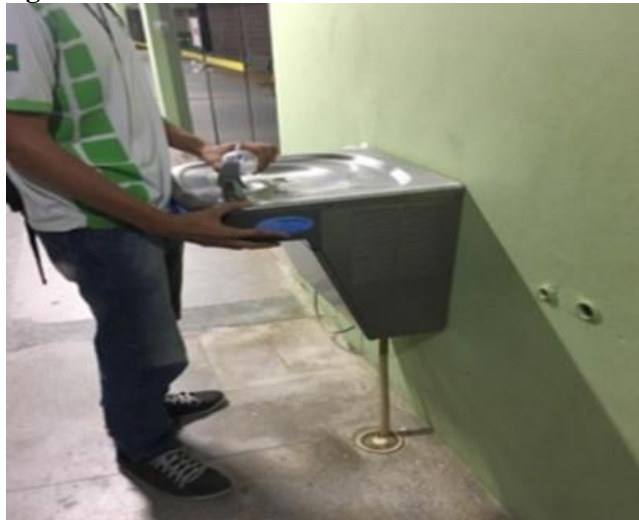
Figura 8. Bebedouro acessível no Bloco Administrativo
