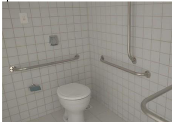
Figura 15. Sanitário acessível com barras de apoio
