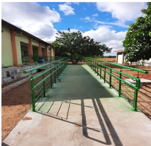
Figura 20. Instalação de corrimãos e guarda-corpo em rampa do bloco Laboratório de Alimentos
