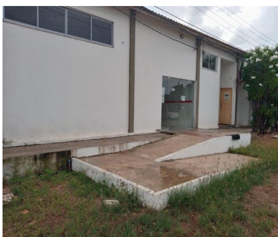
Figura 18. Rampa de acesso com sinalização de piso podotátil na Padaria
