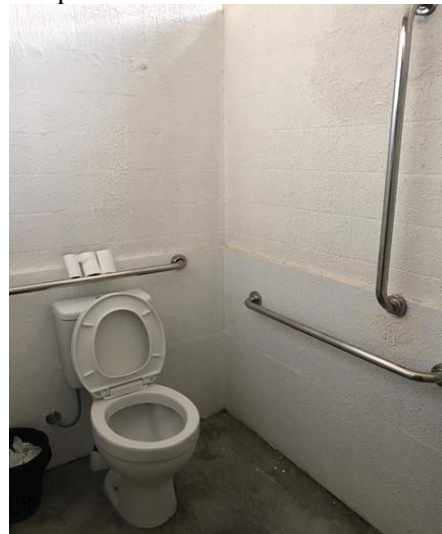
Figura 4. Sanitário acessível com barras de apoio
